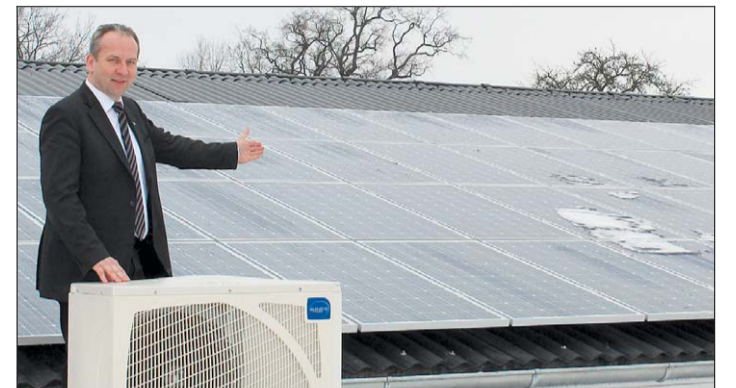
Auf dem Dach der Turmschänke hat Lutz Frank eine Photovoltaik-Anlage mit 21 KW installieren lassen. Den Strom, der durch Sonnenlicht produziert wird, nutzt die Turmschänke selbst.
